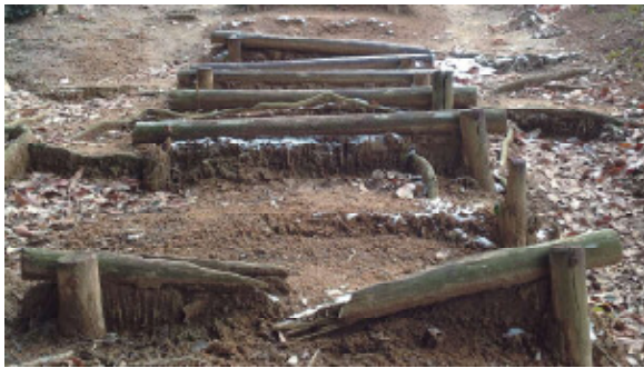
▲現在、傷んでいる遊歩道
