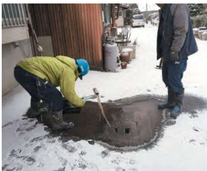
▲1月24日漏水現場にて対応
