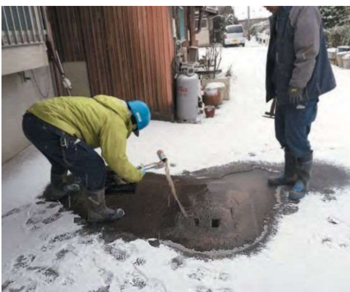
▲1月24日漏水現場にて対応
