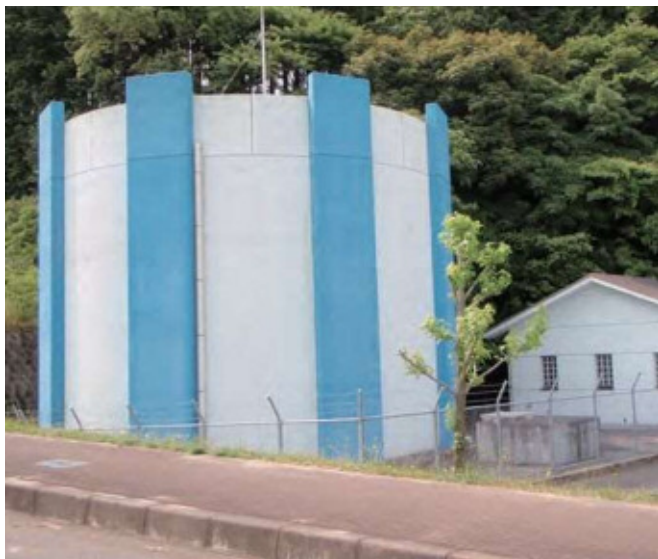
原の前配水池
