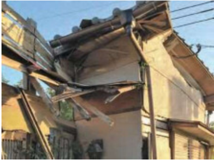
危険な状況の空家
