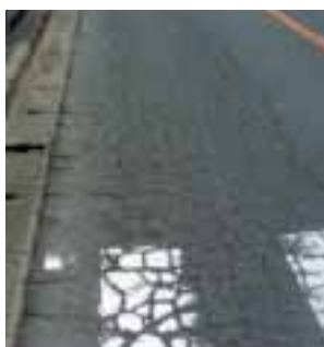
亀裂の入った道路 (ひばりが丘団地)
