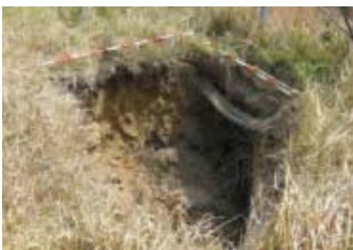
▲鉱害（復旧前）陥没した広場
