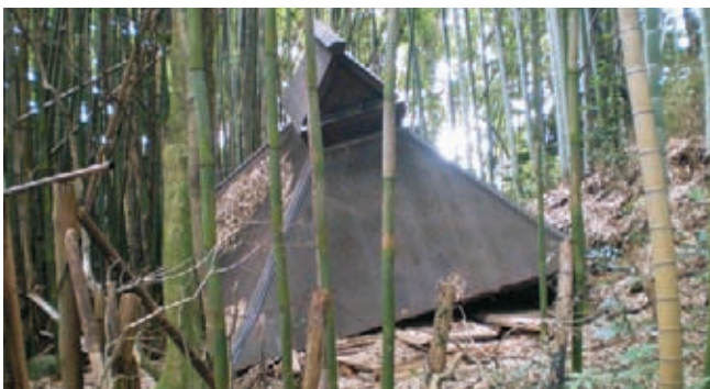
▲崩壊した竹亭
