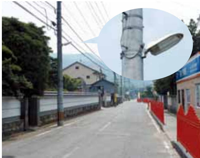
▲設置されたLED防犯灯
