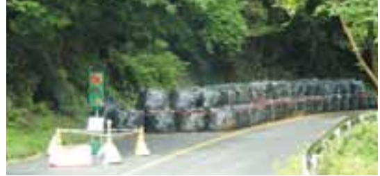
▲指定地域外で法面一部崩壊のため片側通行（四王寺入口）
