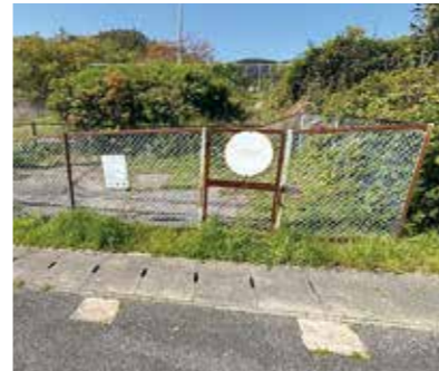
火災時に使用する防火水槽
