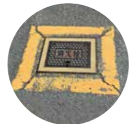
路面標示された消火栓
