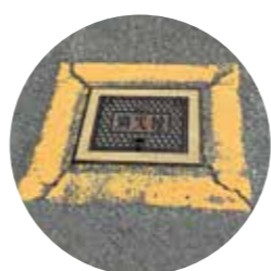
路面標示された消火栓
