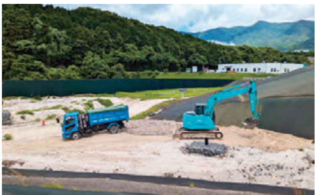
最終処分場（埋立地）
