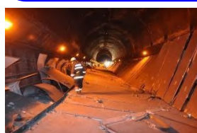
管子トンネル天井板落下事故 (2012)
