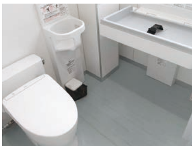
男性用トイレに乳幼児用おむつ交換台を設置
