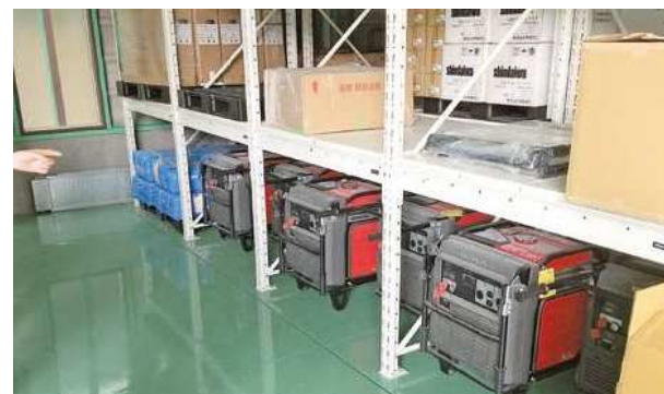
大規模災害での電源喪失に備えて大型発電機を9台準備
