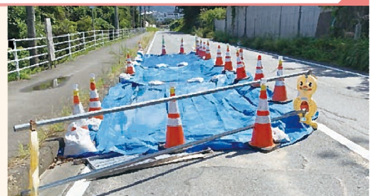
陥没した道路
