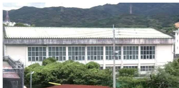
改修が急がれる宇美中学校体育館
