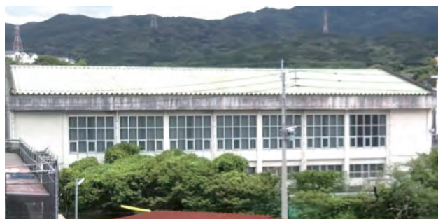
改修が急がれる宇美中学校体育館
