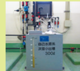
塩素注入機 (消毒をします)
