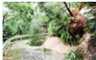
7月豪雨災害で崩壊した林道大久保線
