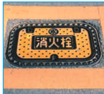
しょうかせん 消火栓
