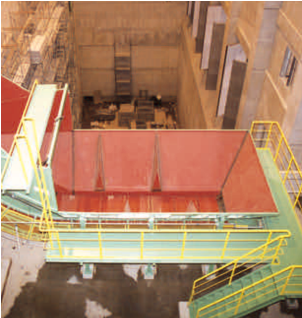
固形燃料製造の一工程
