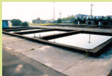
緩速ろ過池 (ごまかいごみ・ほこりをろ過します)
