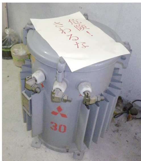
倉庫に保管されている変圧器
