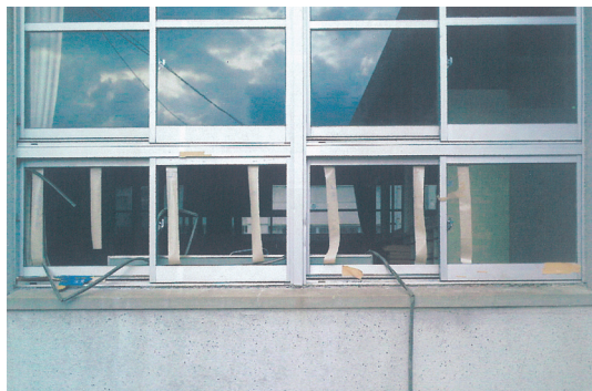
▲被害状況の一部
