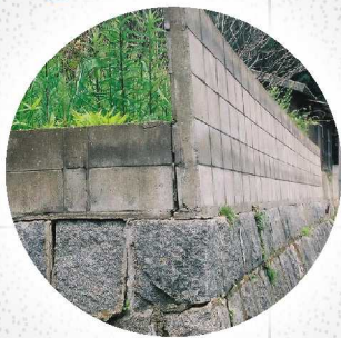
擁壁上のブロック塀 の危険性
