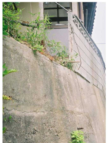
下部の擁壁と一体となるよう施工されず、落下したブロック塀
