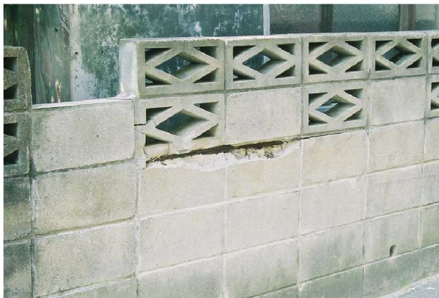
透かしブロックの直下の横筋が腐食し、地震で損傷した事例
