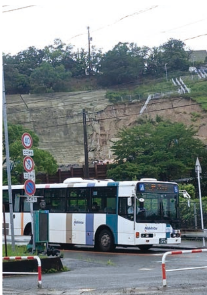
崩壊した ひばりが丘のり面
